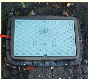
水道メーターボックス
