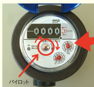
水道メーター
