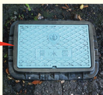
水道メーターボックス
