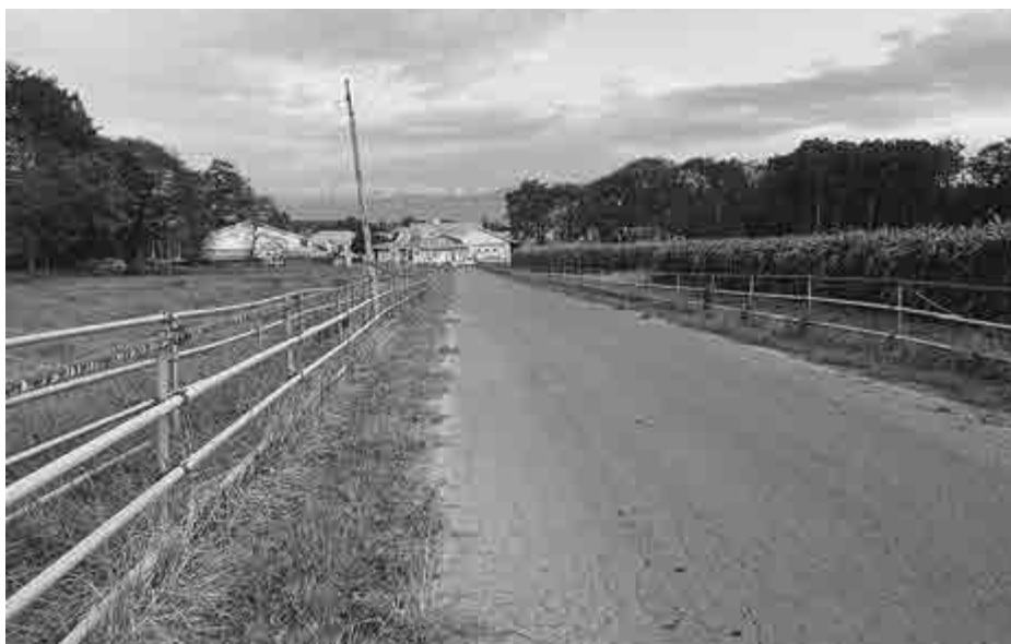
排水対策が望まれる西部地区農道
