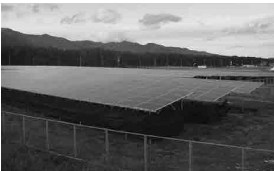
大芝の太陽光発電施設
