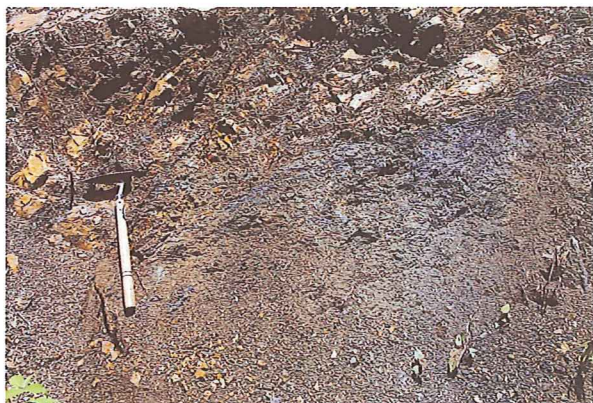
13・3 大泉所山林道 粘板岩と断層 (断層部拡大)
