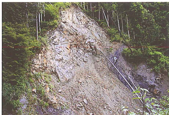
13・7 大泉川上流左岸 珪質粘板岩と断層破碎帯
