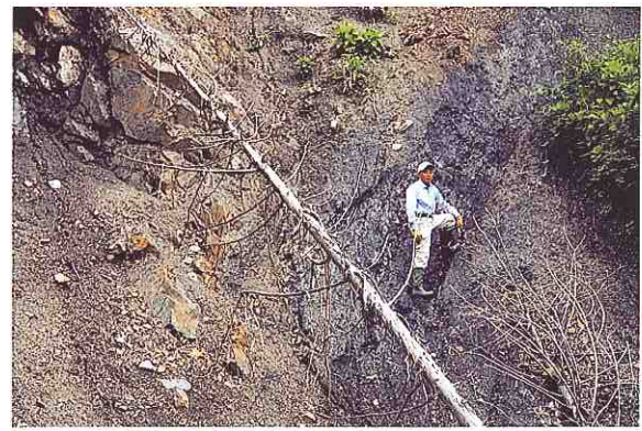
13・8 左写真の破碎帯部分の拡大
