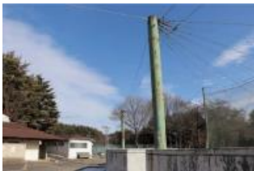
写真 4-1_野球場バックネット支柱状況
