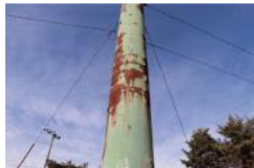
写真 4-2_野球場バックネット支柱錆状況
