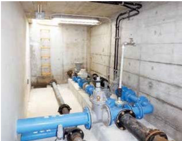
南原配水池緊急遮断弁
