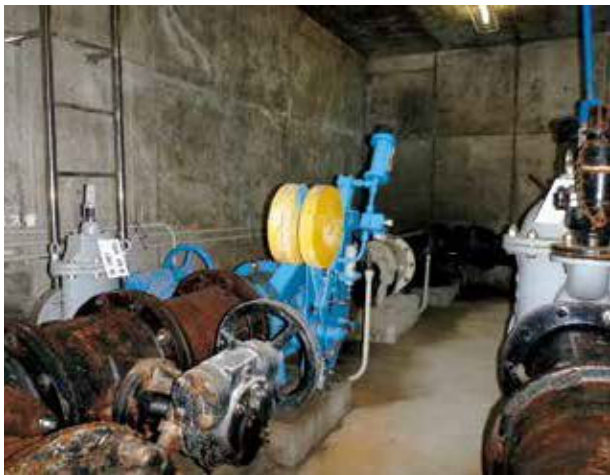
第2配水池緊急遮断弁
