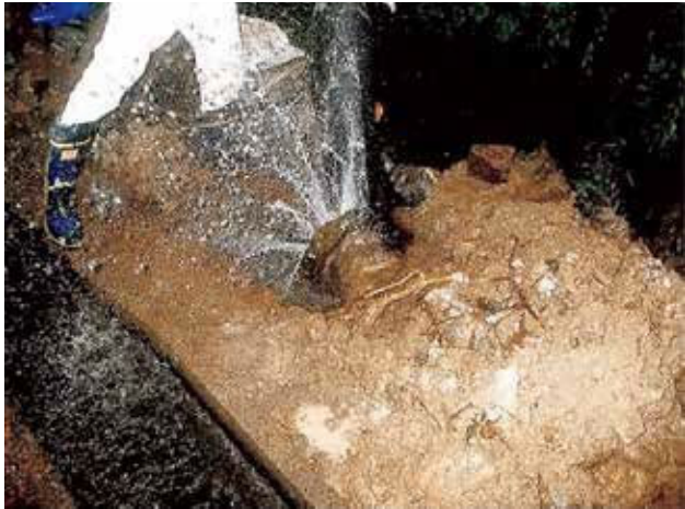
地震における水道管の被害例（出典：厚生労働省 「水道施設の耐震化の推進」）
