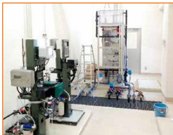
第2配水池油分計水質計器
