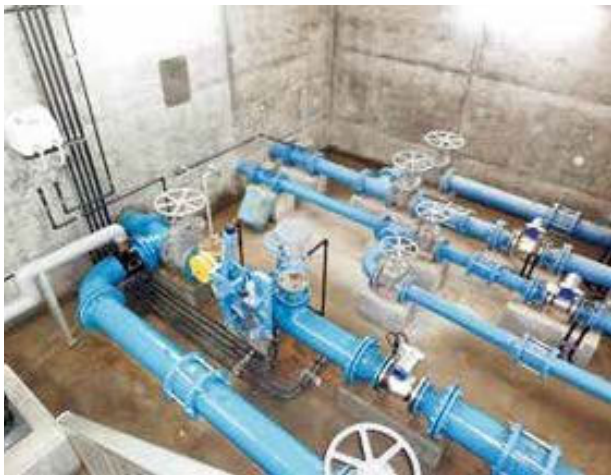
第1配水池緊急遮断弁
