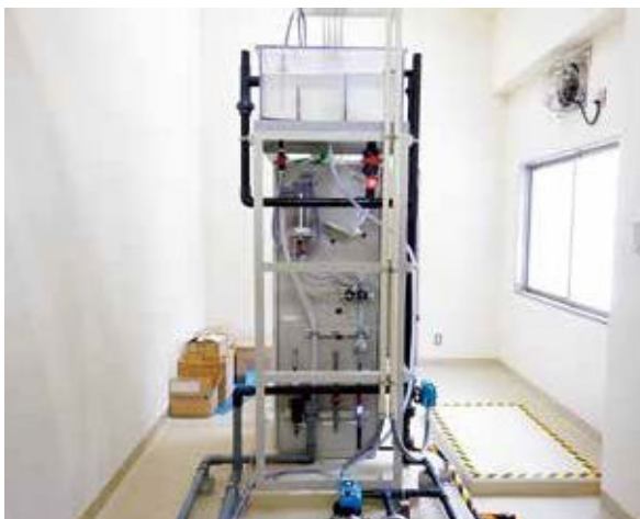
第2配水池 油分監視装置
