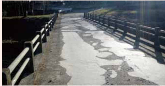
欄干の低い橋の上や近くに深い水路がある場所も、歩行者が落下する恐れがあるため、危険です。歩行者の脇を運転する際は、十分にスピードを落とすようにしましょう。
