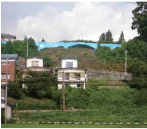
青いシートがかけられている部分で亀裂が確認された
