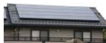
太陽光発電システム
